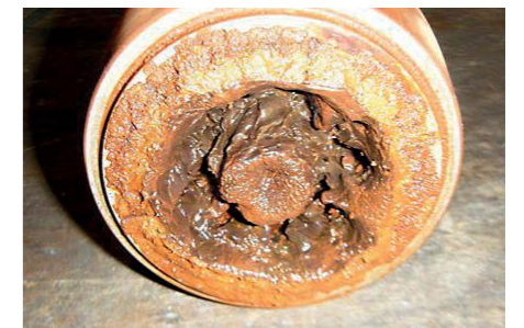
Eisenablagerungen: verockertes Laufrad in einer Unterwasserpumpe
